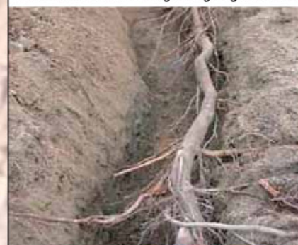
Verkehrsflächensanierung: Freigelegte Wurzel
