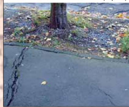
Oberflächennahes Wurzelwachstum (Asphalt)
